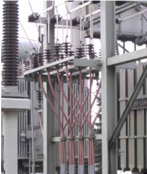
Abb. 14: In diesem Umspannwerk am Rande von Zellerfeld wird bei 20 kV der Strom über Kabel unter der Erde weitergeleitet. Jede der vier Leitungen ist ein Bündel aus drei roten Erdkabeln. stromkabel.htm
