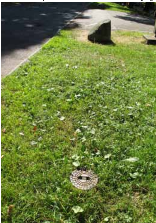
Abb. 11: Diese eiserne Kappe zeigt die Position eines Absperrschiebers an. In welcher Richtung verläuft die Leitung? kanaldeckel.htm
