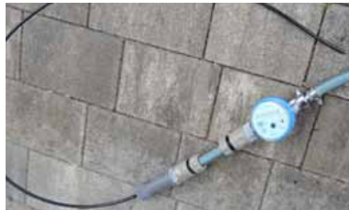
Abb. 02: Wasseruhr mit Gartenschlauch und Übergangstück zur dünneren Leitung
