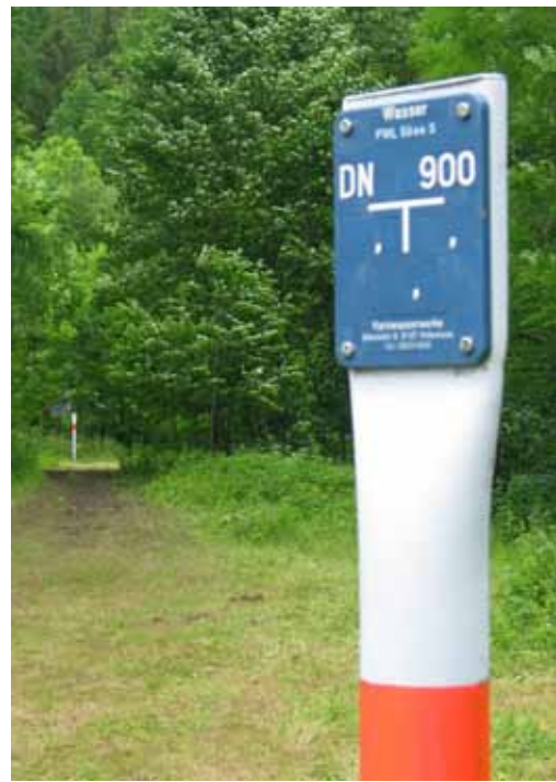
Abb. 12: Gut sichtbar ist hier der Verlauf einer Fernwasserleitung mit 900 mm Durchmesser markiert. Der nächste Pfosten steht in Sichtweite im Hintergrund links. Hier ist eine gute Gelegenheit, die spürbaren Eigenschaften einer Leitung zu untersuchen und das Verfahren zu trainieren.
